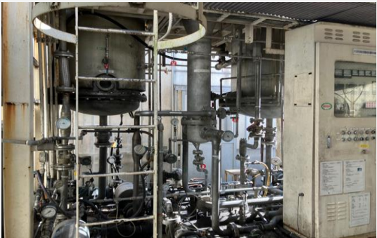
工場廃液を濃縮装置で現用
