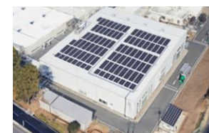
武蔵精密工業 本社工場(愛知県) 太陽光パネル
