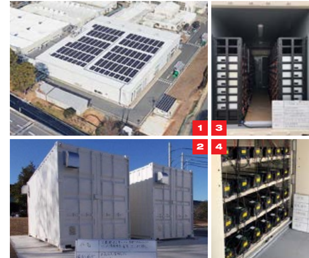
1 本社・新南工場 太陽光パネル設置 2 蓄電池コンテナ 3 蓄電池600kW:蓄電池コンテナ内に、蓄電池とHSCを設置 4 EMS:HSC24直MD/4×6並
