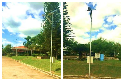
導入したソーラー街路灯
