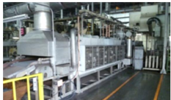
改善を実施した均熱焼準炉
