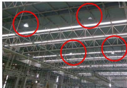
LED化したKARAWANG工場の天井灯
