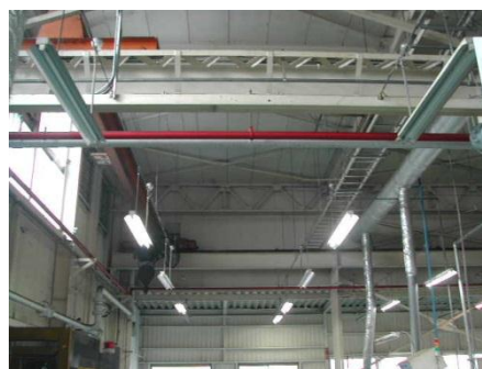
工場内照明の様子
