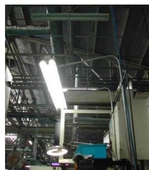
天井照明と手元灯
